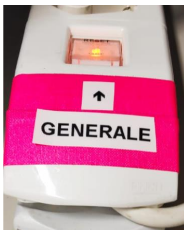
Figure 2 Interruttore generale per accendere/spegnere la strumentazione audio/video
